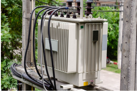
Elektrik dağıtım ağlarında kullanılan bir trafo
