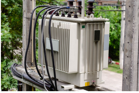
Elektrik dağıtım ağlarında kullanılan bir trafo
